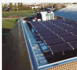
Amandiers. Complejo deportivo. Carrières-sur-Seine, Francia. ECOi-W.
